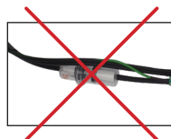
冷凝水槽 错误
