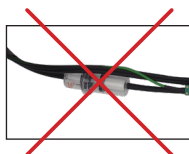
Posição incorreta da câmara de condensados
